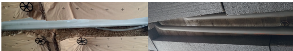
Exemples d'isolation à 1€ inefficaces : de sérieux ponts thermiques ou fuites de chaleur !
